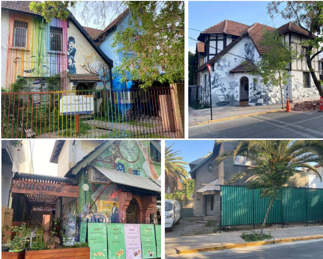
Figura 35 Fotos deterioro fachas ZCH Población Salvador Legión Militar de Chile. Fuente: Elaboración propia.
